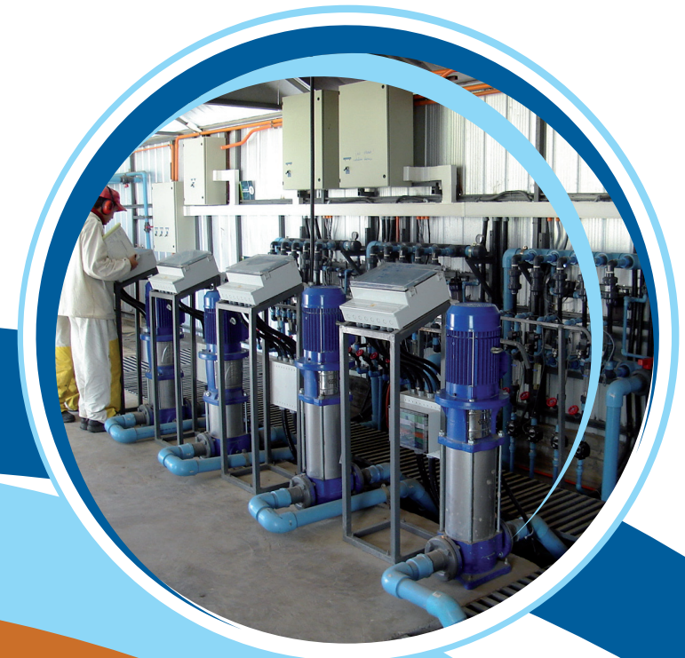
Equipo automatizado para fertirriego
